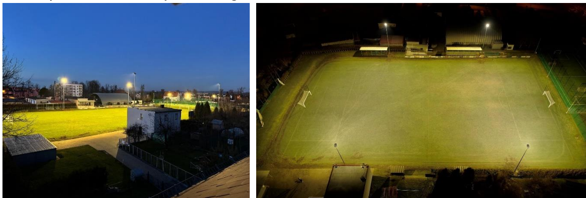
Boisko KS Kolejarz Chatupki po wykonaniu oświetlenia
