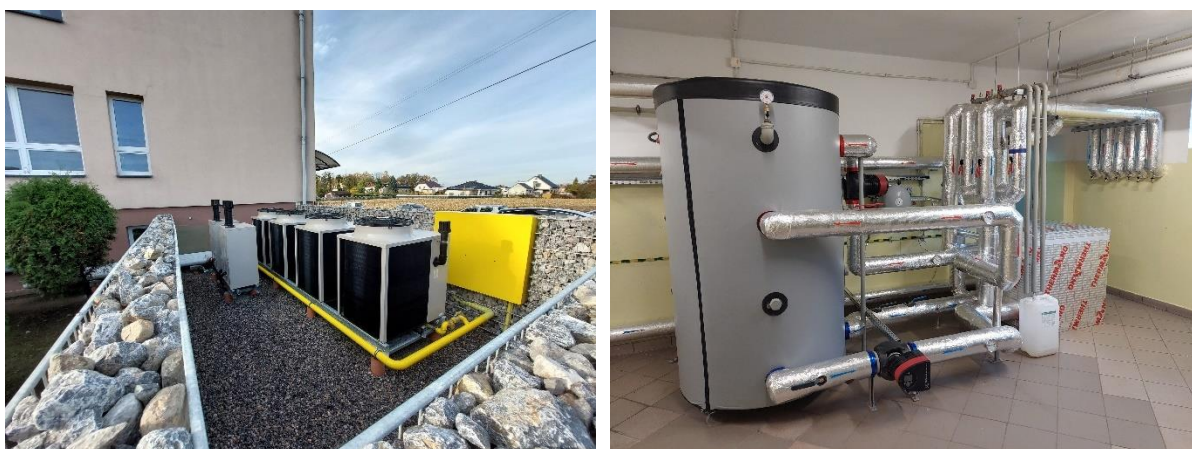
Szkoła Podstawowa w Krzyżanowicach - tutaj zamontowano 4 absorpcyjne, powietrzne pompy ciepła zasilane gazem oraz dwa kotły gazowe.
