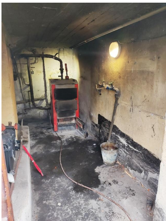
Zdjęcie kotłowni przed wykonaniem modernizacji
